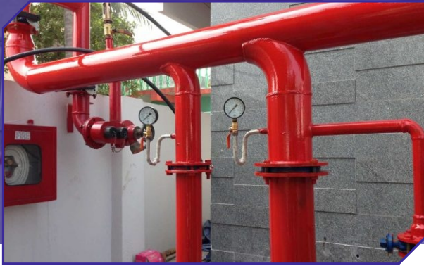
► Fire Hydrant Line
